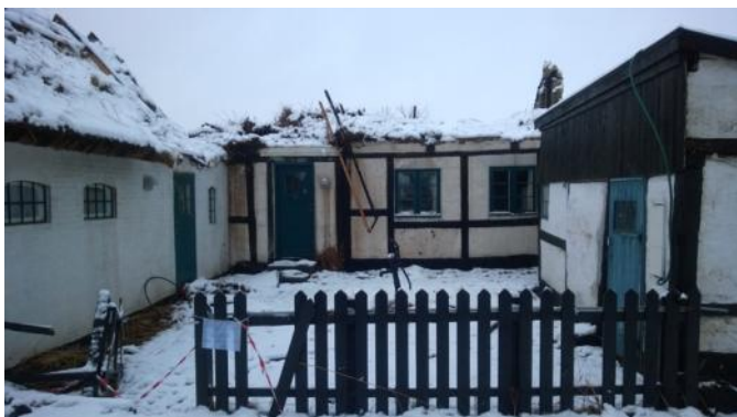
Det brændte hus. Foto fra 2018
